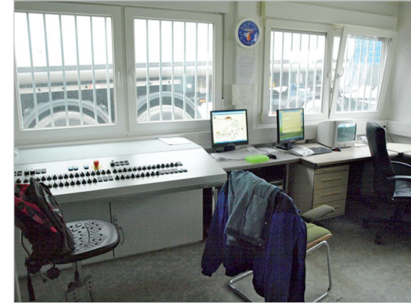
Sand- und Kieswerk am Niederrhein. Leitstand mit Bedienpult, Visualisierung und Verladesteuerung
